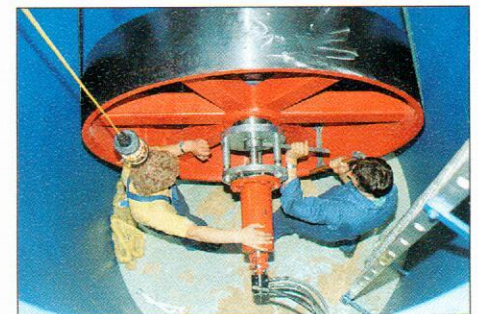
Kaum mannshoch ist der Generator, der von einer unter ihm liegenden Kaplan-Turbine angetrieben wird.
